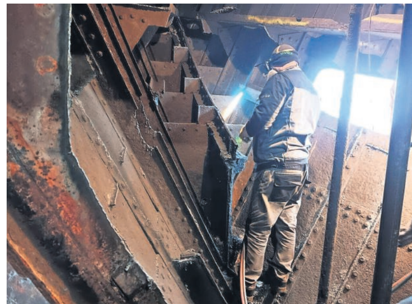
Das Hauptaugenmerk der Werft liegt auf den Tanks. Viele Spanten und Schotten müssen erneuert werden.
